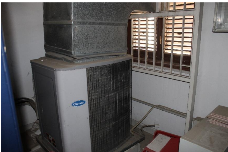
Vista del locale tecnico (UTA)
