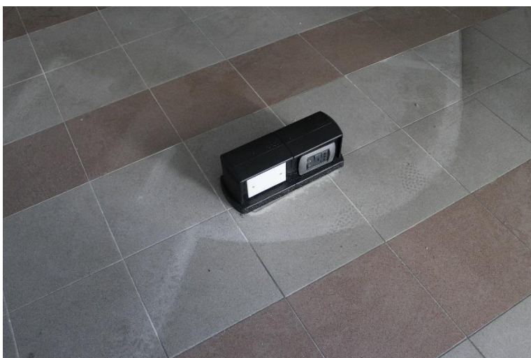
Vista della torretta porta apparecchi a pavimento
