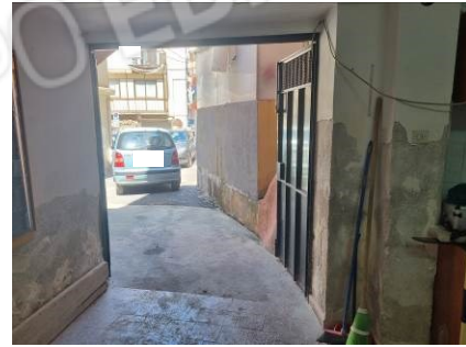
Foto n. 37 P.T. - Locale Box.
