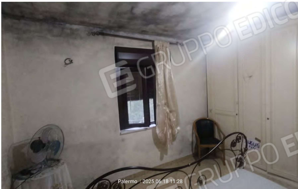
Foto 15 – Particolare condensa sul tetto della stanza da letto
