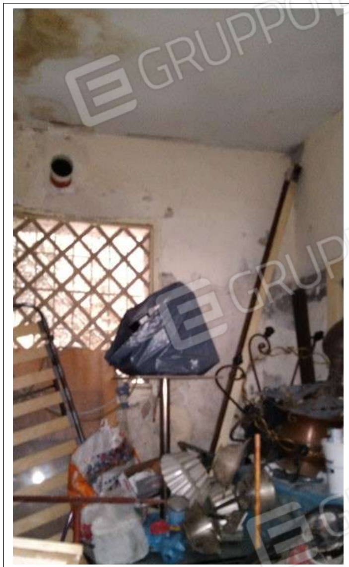
Foto n. 8. Vano prospettante sulla chiostrina interna al fabbricato di cui fa parte il bene pignorato
