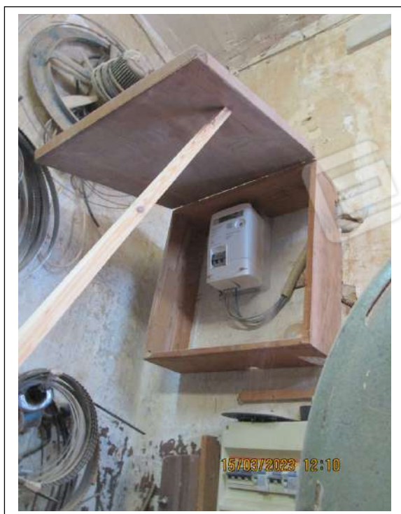
Foto n. 7 - 8. Quadro elettrico e contatore della luce ubicati nel secondo vano del magazzino
