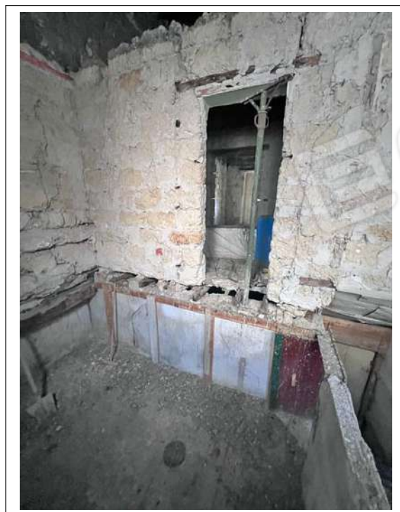
Foto n. 35-36. Immobile identificato al sub. 15 in cui è crollato il solaio di calpestio
