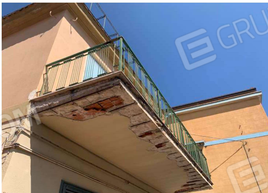
Foto n. 5 - Stato del balcone di prospetto
