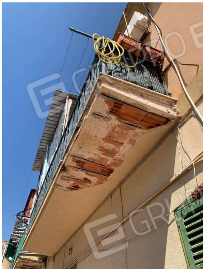
Foto n. 6 - Stato del balcone laterale
