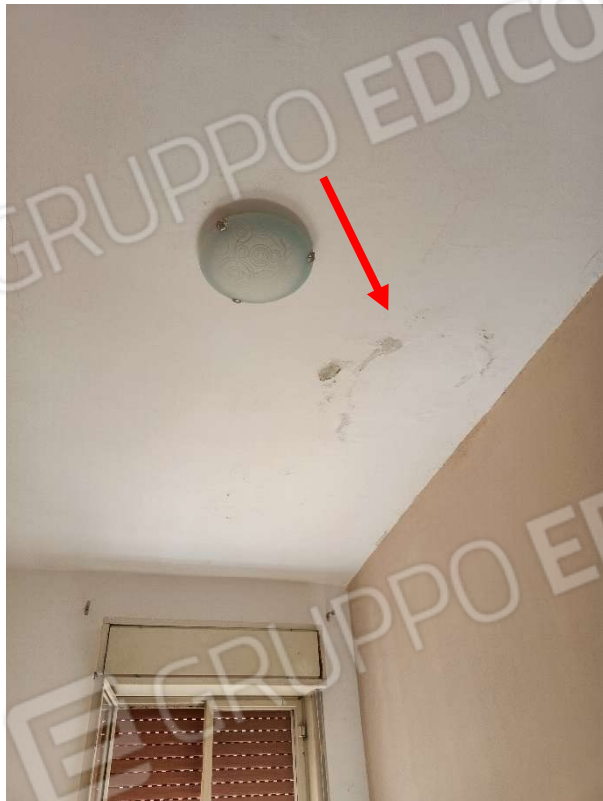
Foto n.14 – ammaloramenti soffitto ripostiglio
