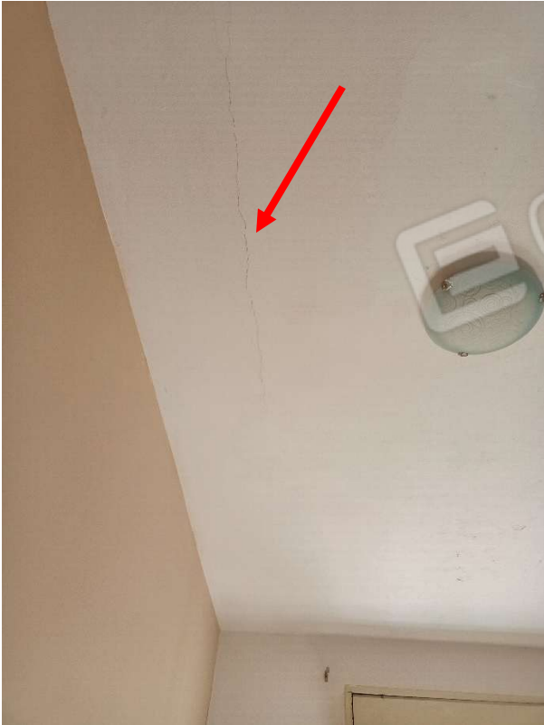
Foto n.13 – lieve lesione soffitto ripostiglio
