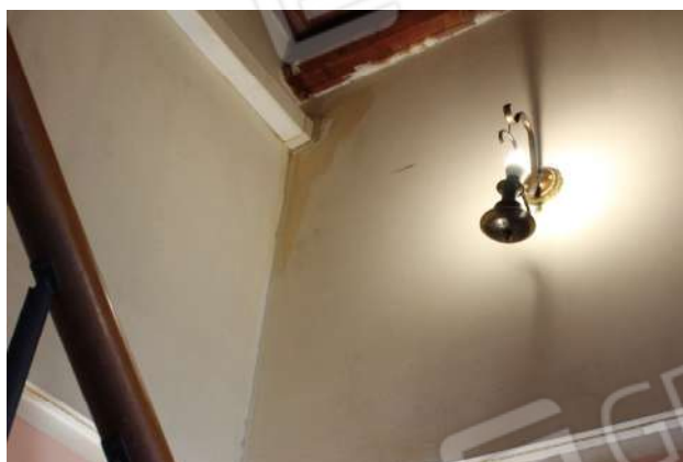
Foto n.23: Macchie da infiltrazione su muratura perimetrale
