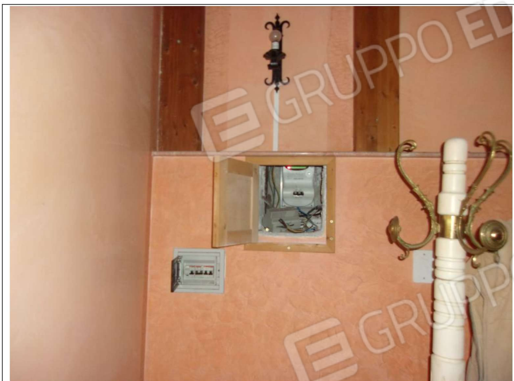
Foto n. 36 linea accesso impianto elettrico
