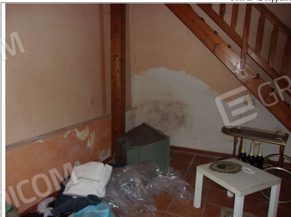
Foto n. 43 tracce di umidità piano terra
