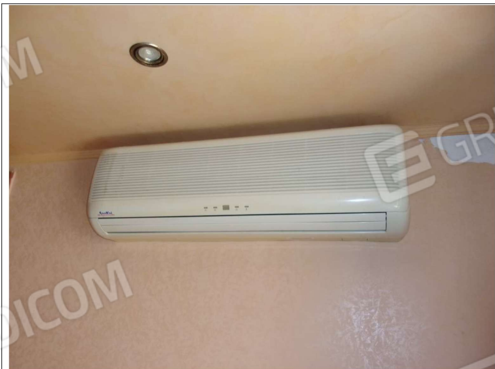
Foto n. 31 impianto interno climatizzatore
