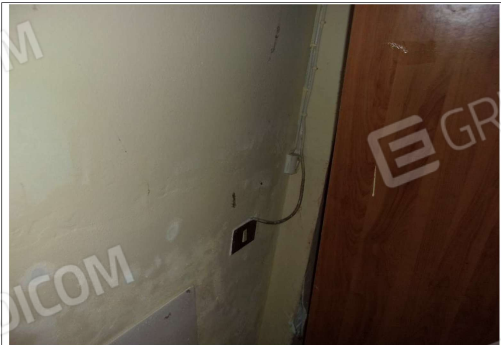
Foto n. 17 infiltrazioni da perdita cisterna ed impianto elettrico
