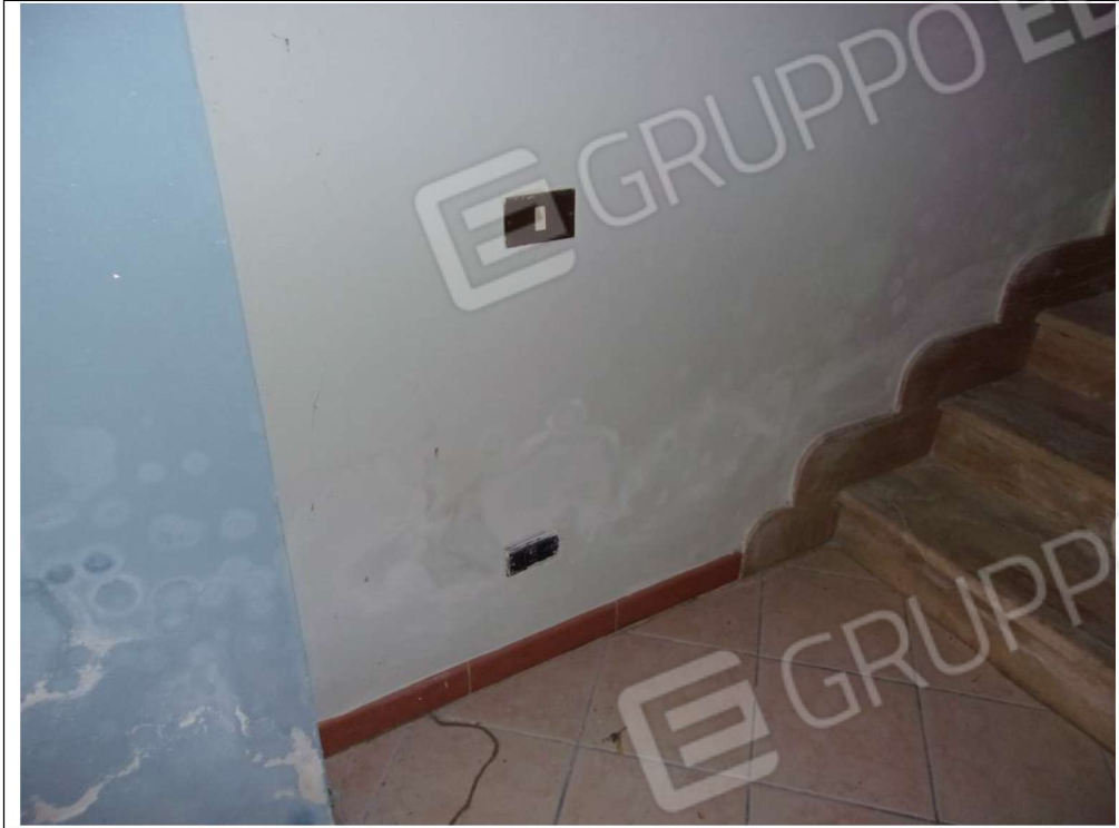
Foto n. 16 infiltrazioni da perdita cisterna ed impianto elettrico
