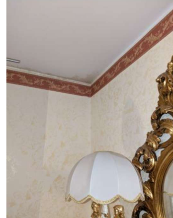
Foto 18: Tracce di umidità sul soffitto della camera
