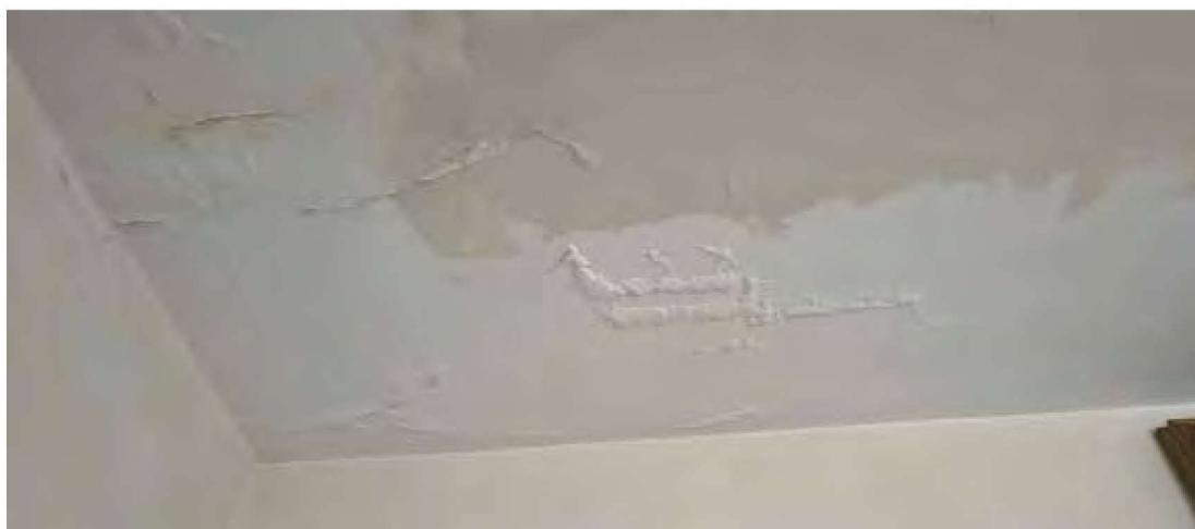
Foto nn. 24 - 26: Nuove infiltrazioni. (sopralluogo del 20/04/2026)
