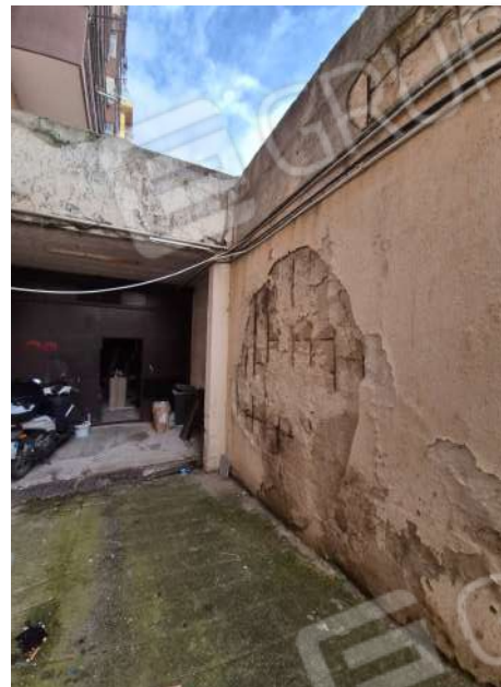
Foto n. 20 – Dissesti allo scivolo di accesso
