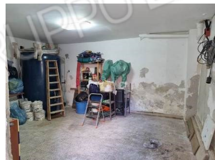
Foto n. 40 P.T. - Locale Box.
