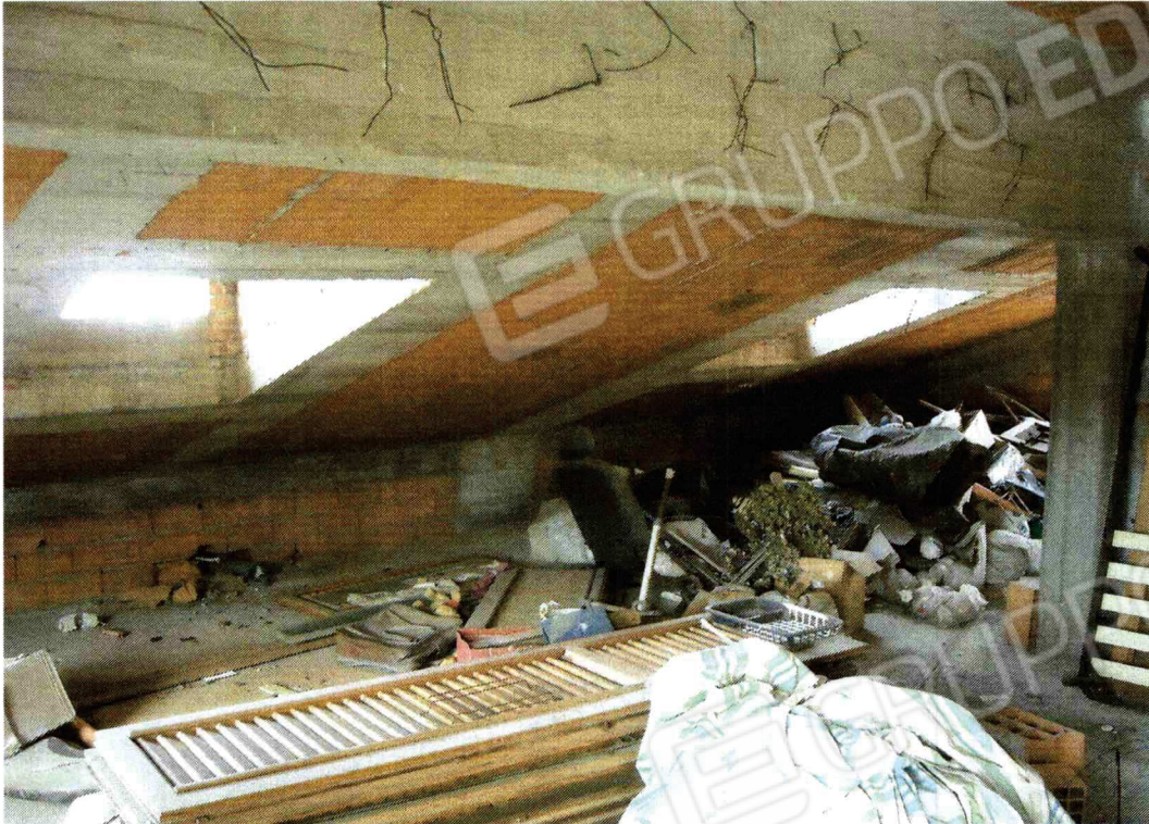
FOTO N. 5 – INTERNO SOTTOFALDA LATO NORD
