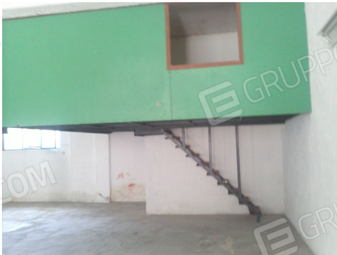
Foto 06. Struttura in ferro presente all'interno del locale identificato al catasto al foglio 37 part. 13 sub 5.
