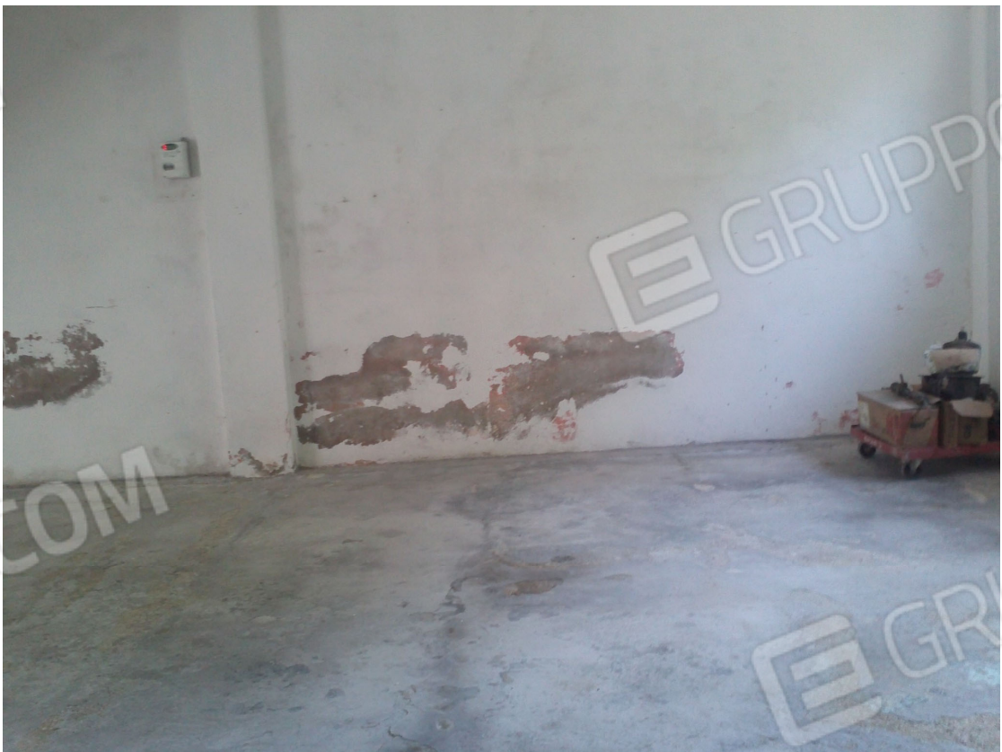
Foto 04. Umidità all'interno degli immobili.
