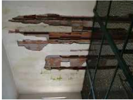
Foto 194-195 vano D1 - locale tecnico (cabina elettrica)
