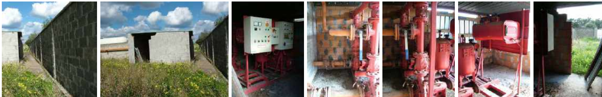
Foto 294 confine est del cespite Foto 295-296-297-298-299-300 vano L1 - locale tecnico (locale pompe antincendio)
