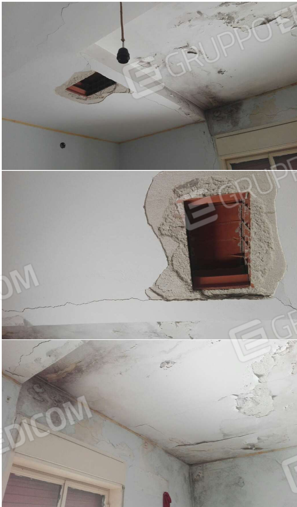
G.05 – G.06 – G.07 - Particolare delle parti di solaio e parete interessate da fenomeni di ammaloramento degli intonaci, fessurazioni e lesioni nella muratura e distacco di elementi in laterizio che compongono le pignatte del solaio.
