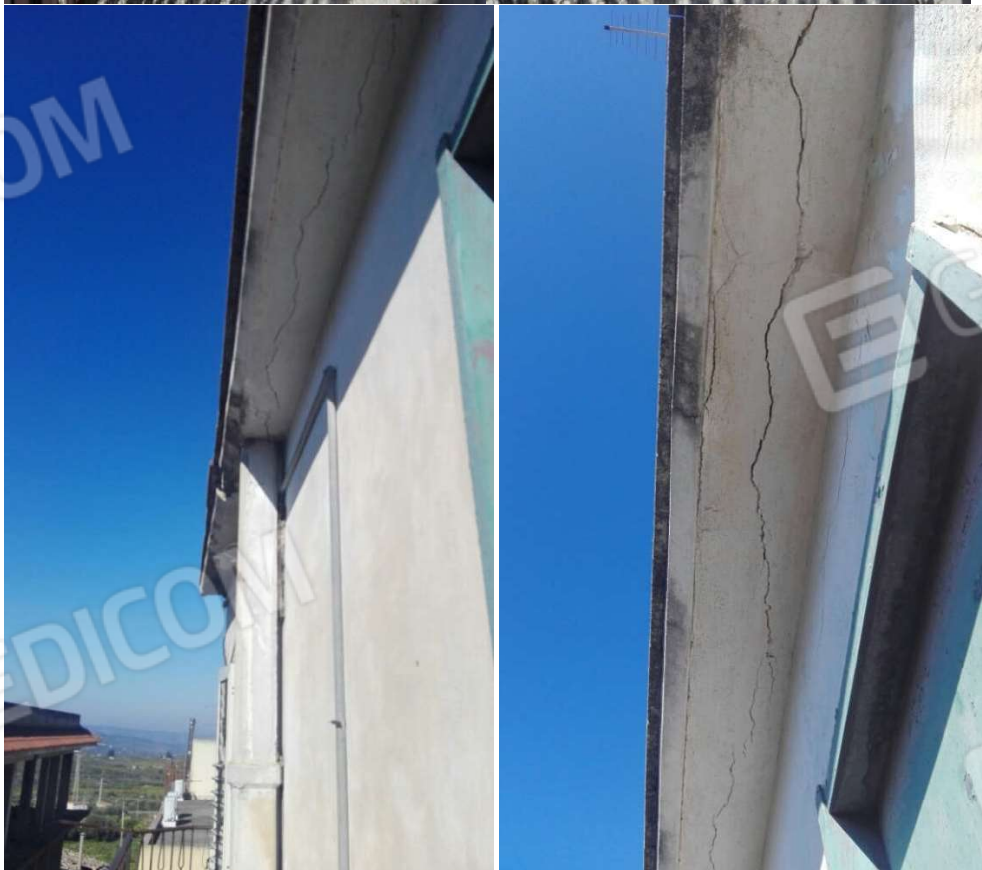
G.10 – G.11 – G.12 – G.13 -- Parti esterne del prospetto Est. Particolare delle lesioni e fessurazioni diffuse nella soglia del balcone e nella pensilina di protezione della facciata, da cui infiltra l'acqua piovana.
