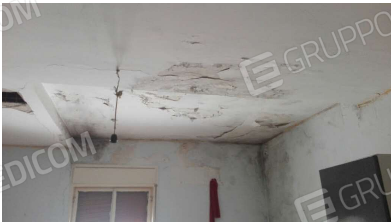
G.03 – G.04 - Veduta interna generale del vano al secondo piano, la porzione di tetto interessata dai fenomeni infiltrazione di acqua piovana e conseguente degrado e distacco degli intonaci e del materiale laterizio è nella parte sud-est dell'edificio.
