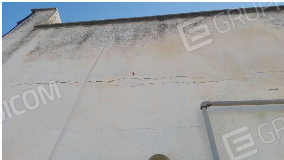
G.17 – G.18 – G.19 -- Parti esterne prospetto Sud. Particolare delle lesioni e fessurazioni diffuse, sia verticali (forse per mancanza di ammortatura tra murature di diverso tipo) sia orizzontali (forse per distacco del coprifermo del cordolo perimetrale di copertura) con conseguente infiltrazioni di acqua piovana.
