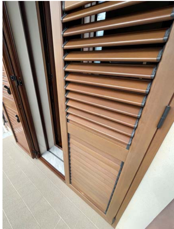
Dettaglio fotografico degli oscuranti esterni
