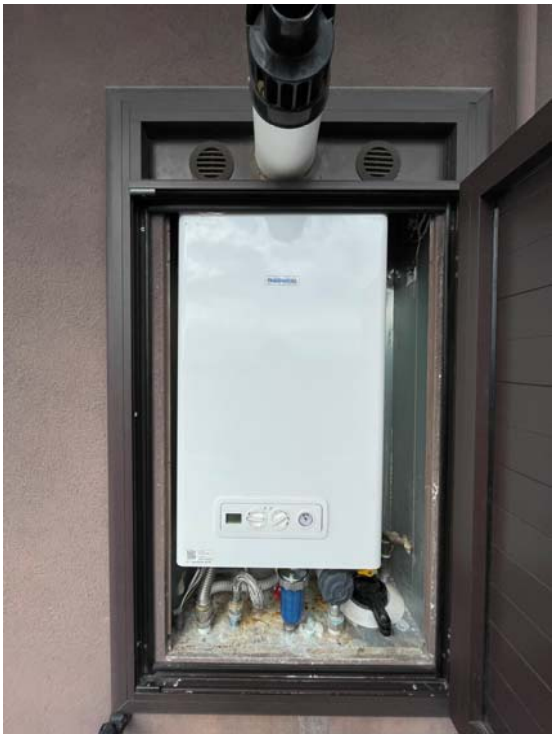
Dettaglio fotografico della caldaia
