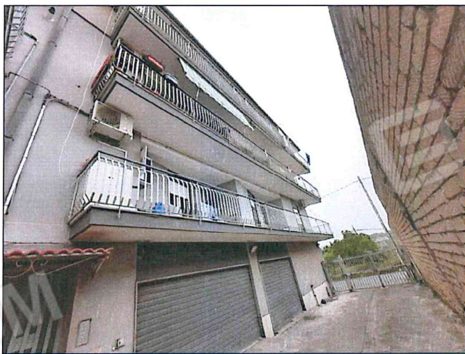
Foto 4-5 - Vista dei prospetti aventi affacci con balconi a giro su via Sant'antonio e su strada privata interna; da quest'ultima si accede ai garage ed al corpo scala A. Le facciate e i balconi si trovano in buono stato conservativo.
