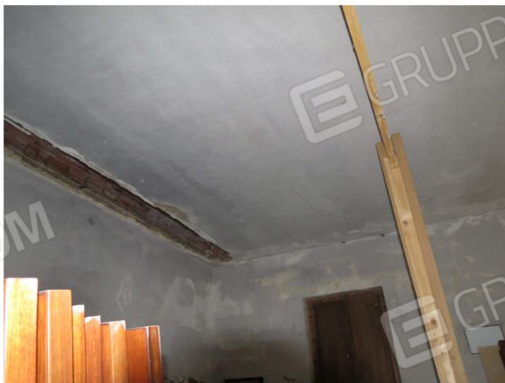
Foto n. 22: Interno corpo 4 (particolare solaio con fenomeni di sfondellamento)
