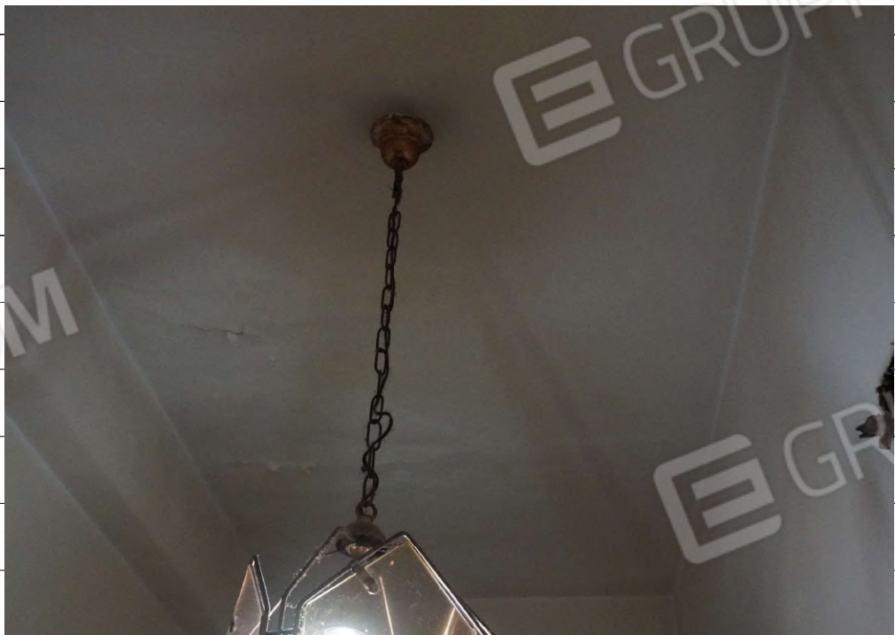
Foto n.22: immagine interna di parte del soffitto del disimpegno.
