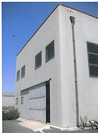
FOTO N° 13 - BENE N° 2 PARTICOLARE DEL PORTONE IN FERRO BUGNATO
