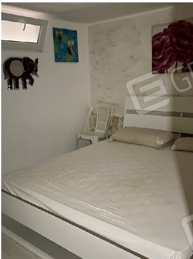
Foto 9: Vista vano attualmente adibito a camera ma autorizzato come ripostiglio
