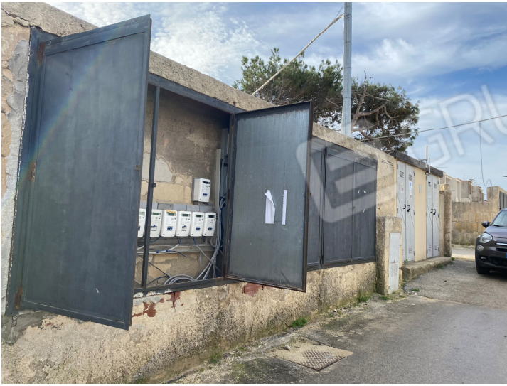
Foto 11: Vista vano contatori ubicato sul muro di cinta esterna del residence
