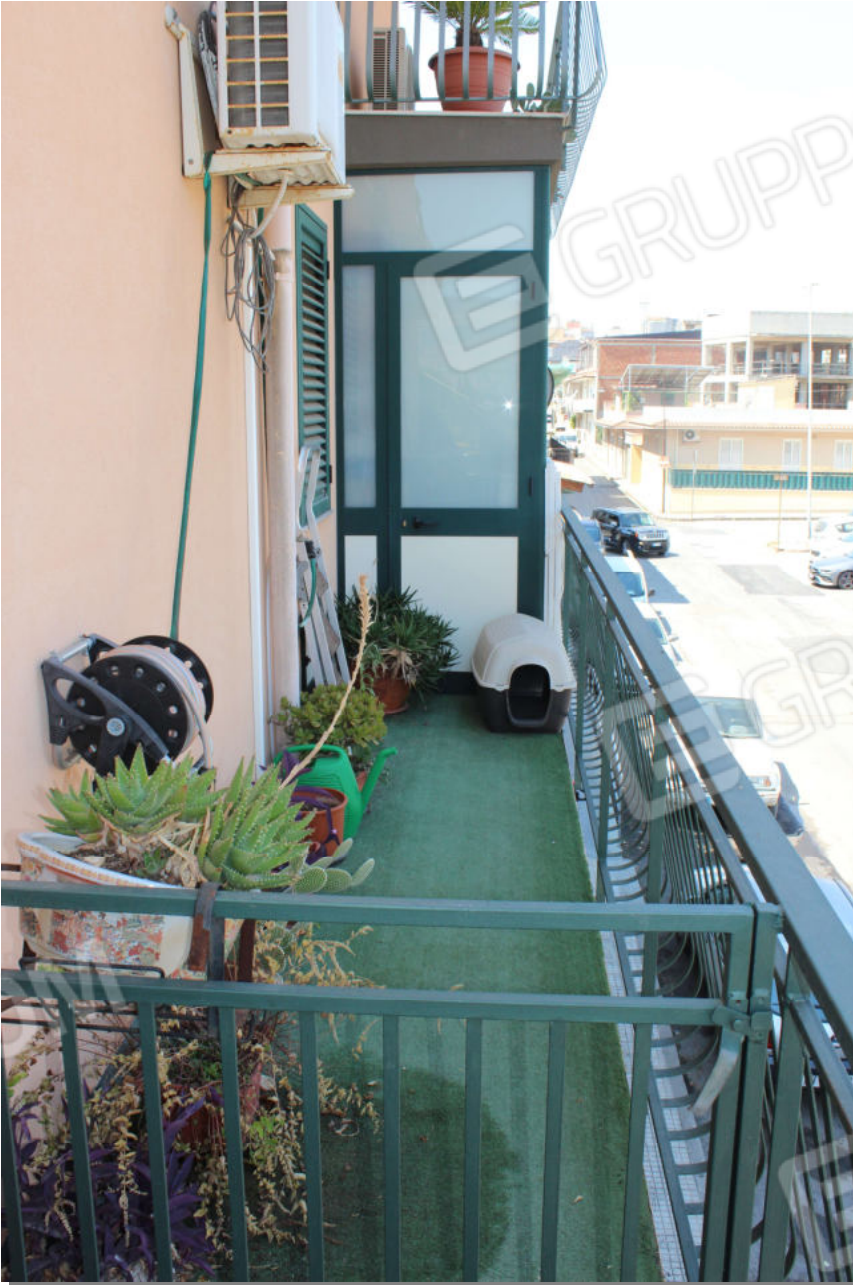
Foto n. 13 – Vista balcone con struttura precaria
