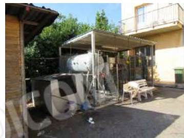
Foto 136 – Tettoia gruppo pompe antincendio
