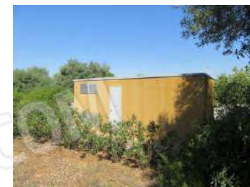
Foto da 45 a 48 – Cabina elettrica
