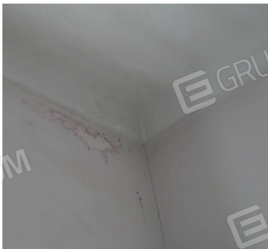
foto 14_ particolare del degrado sulle pareti e soffitto
