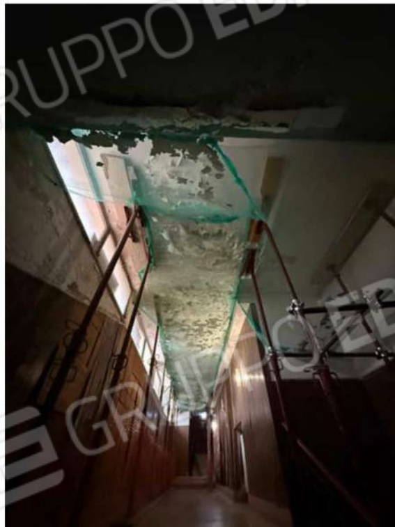
Danni sulle parti interne dell'androne condominiale
