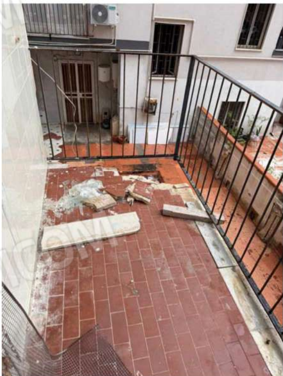
Porzioni di balcone crollate
