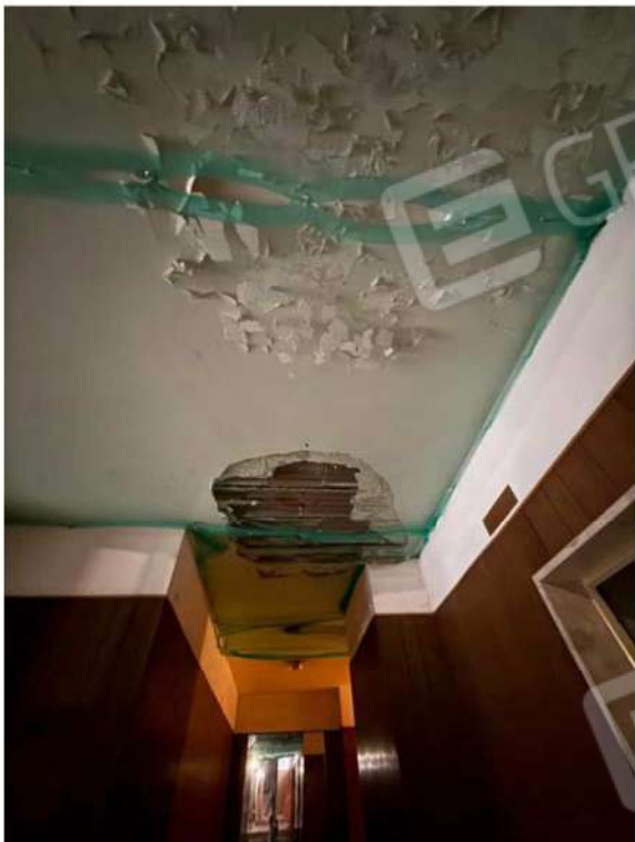
Danni sulle parti interne dell'androne condominiale
