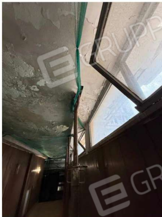
Danni sulle parti interne dell'androne condominiale
