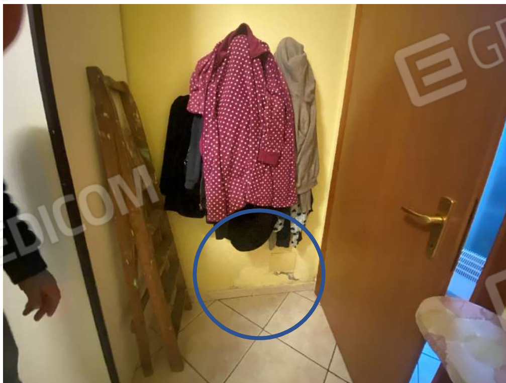
Foto 14: Vista segni di umidità
