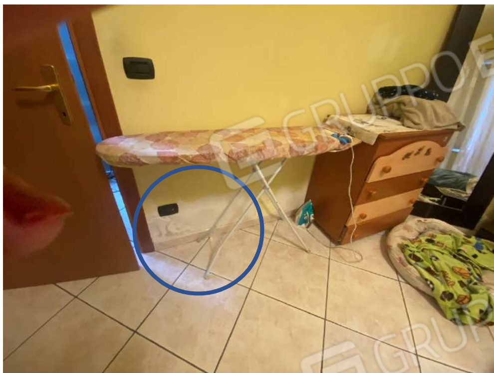
Foto 15: Vista segni di umidità
