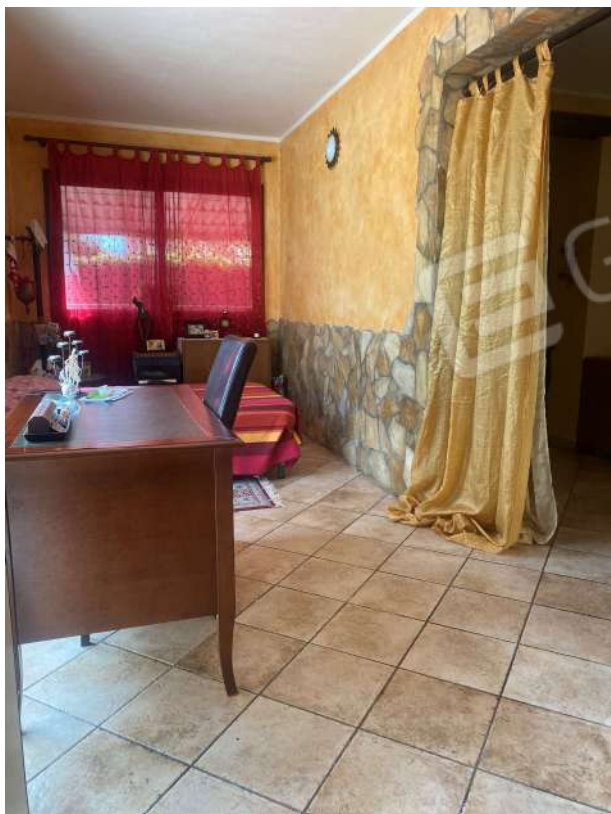
Foto 9: Vista veranda coperta, attualmente fusa all'u.i., per la quale è necessario installare una porta finestra in modo da separare tale vano dal soggiorno e ripristinarne la destinazione d'uso di veranda coperta.
