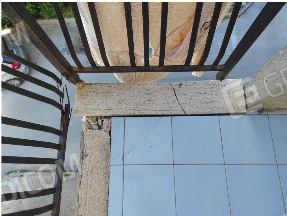
Foto 20 - balcone 2, pessime condizioni di manutenzione
