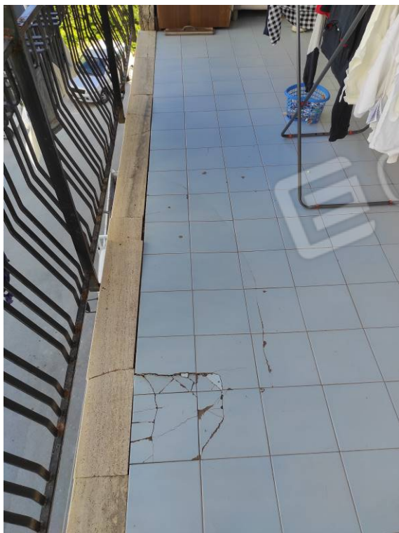
Foto 21 - balcone 2, pessime condizioni di manutenzione
