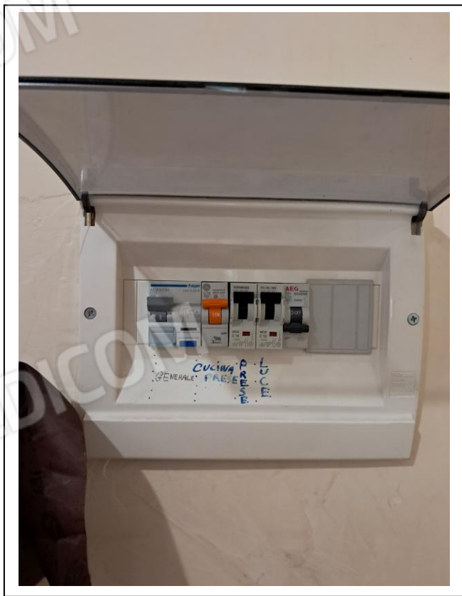
06. Quadro elettrico dell'appartamento con presenza di interruttore differenziale (salvavita), messa a terra ed interruttore magnetotermico.
