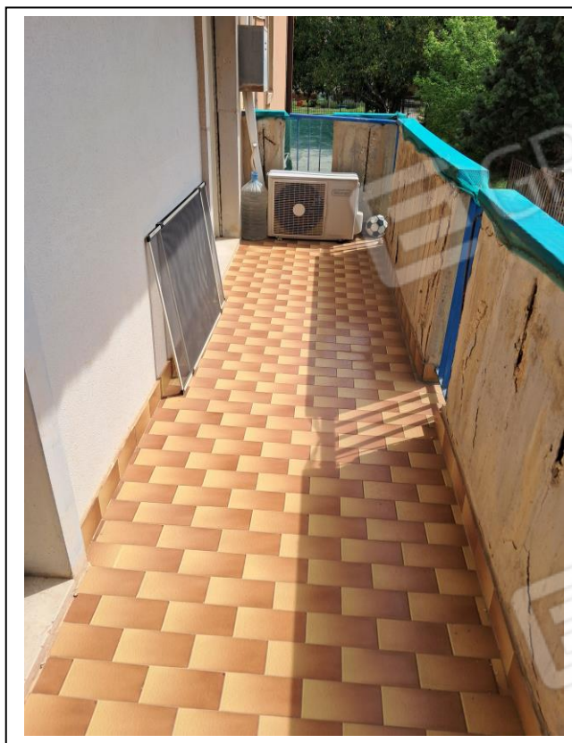
25. Esterno dell'unità immobiliare con vista verso lato nord-est, in foto balcone in aggetto in cattivo stato di manutenzione.
