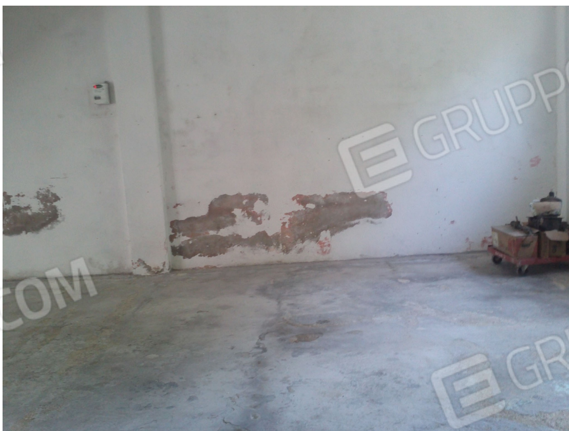
Foto 04. Umidità all'interno degli immobili.
