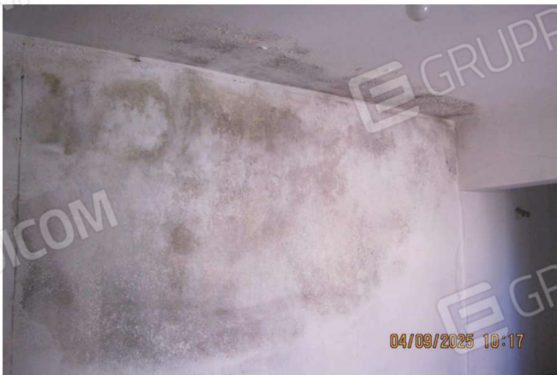
Foto 43: ancora una rappresentazione fotografica dello stato manutentivo del vano al terzo piano
