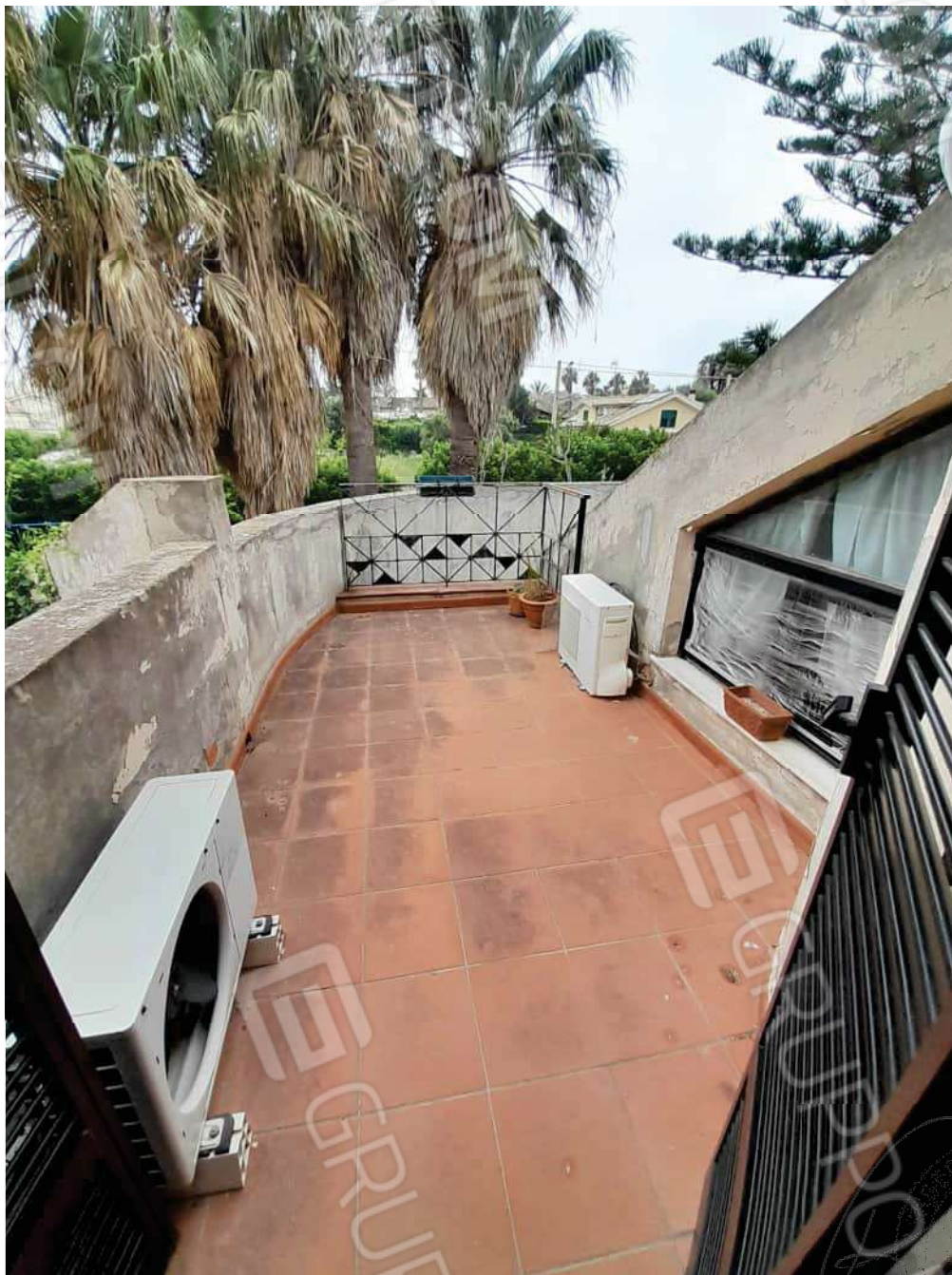
Foto n°25 - Vista del terrazzino ampliato abusivamente di pertinenza
