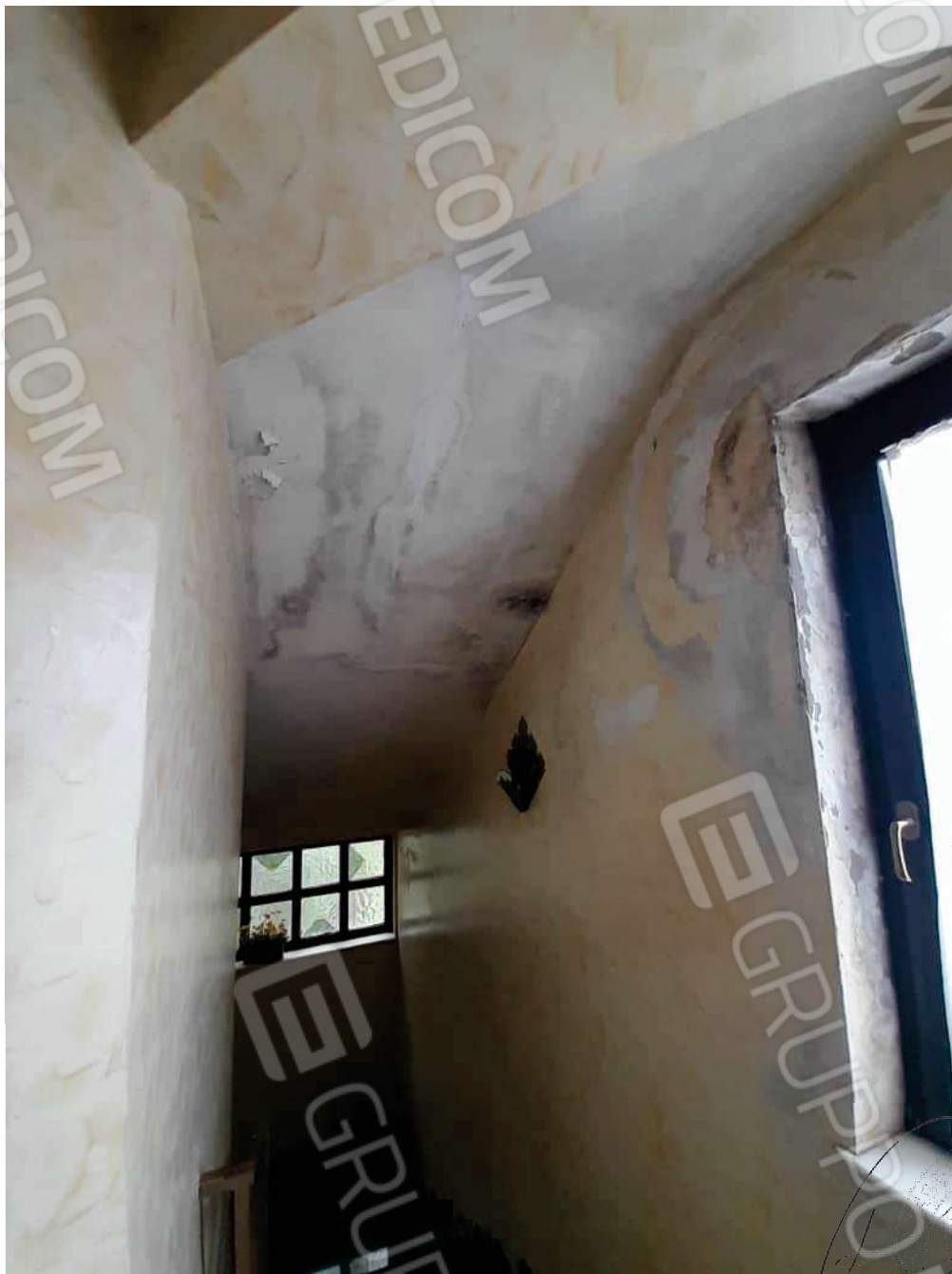
Foto n°17 - Particolare dei danni esistenti nel vano scala e nel disimpegno al primo piano
