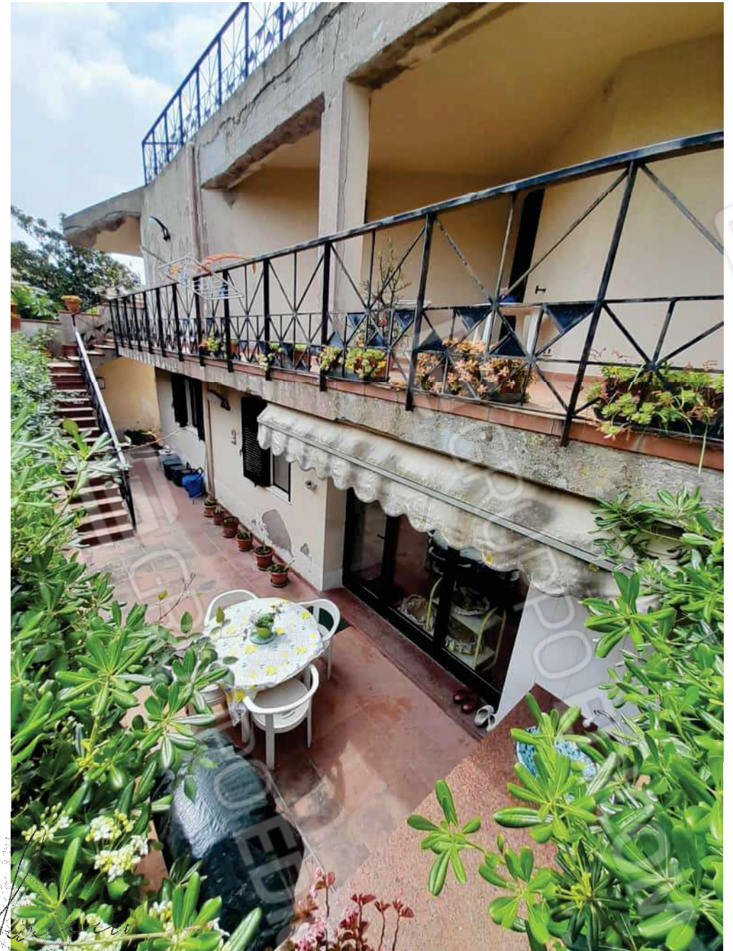
Foto n°6 - Particolare del piano seminterrato e della sovrastante balconata abusiva
