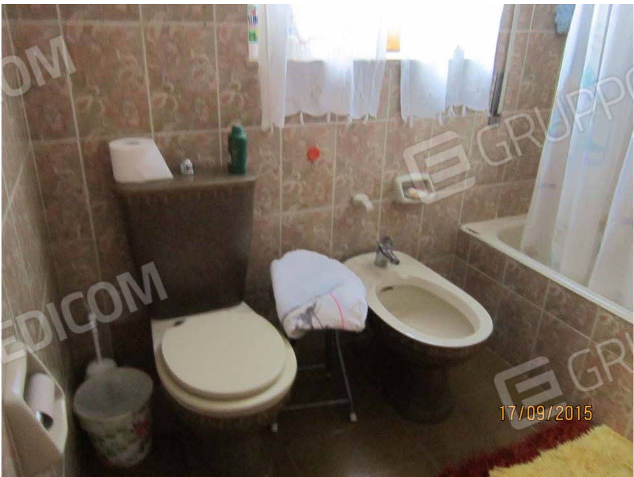
Foto n° 12 – Appartamento a Buccheri – Bagno a 2° piano
