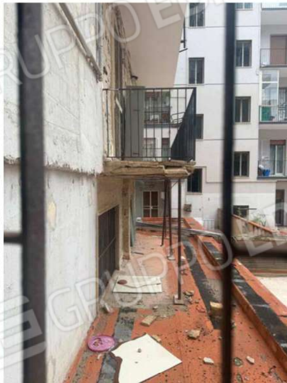
Danni sulle parti esterne dell'immobile pignorato
