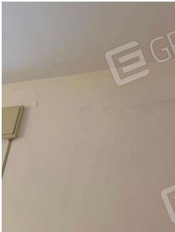
Lesioni sulla parete interna confinante con l'esterno
