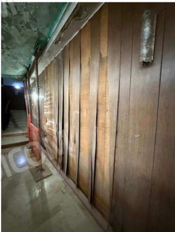
Danni sulle parti interne dell'androne condominiale
