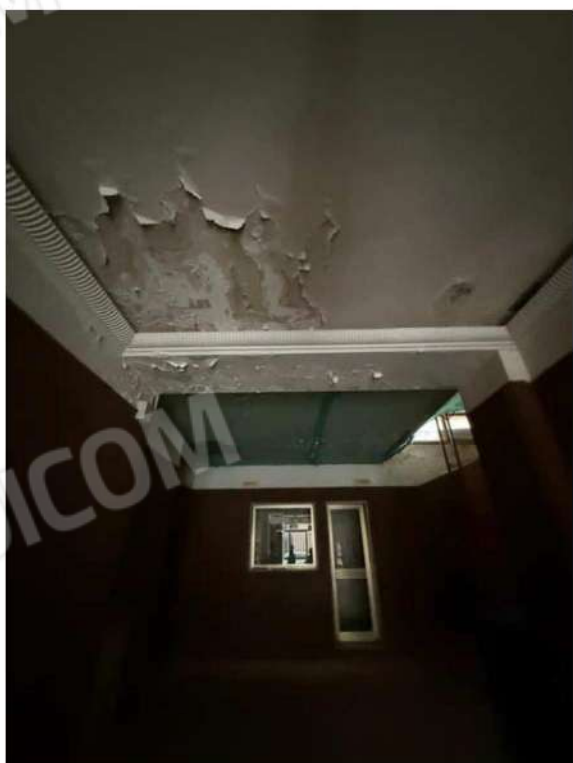
Danni sulle parti interne dell'androne condominiale
