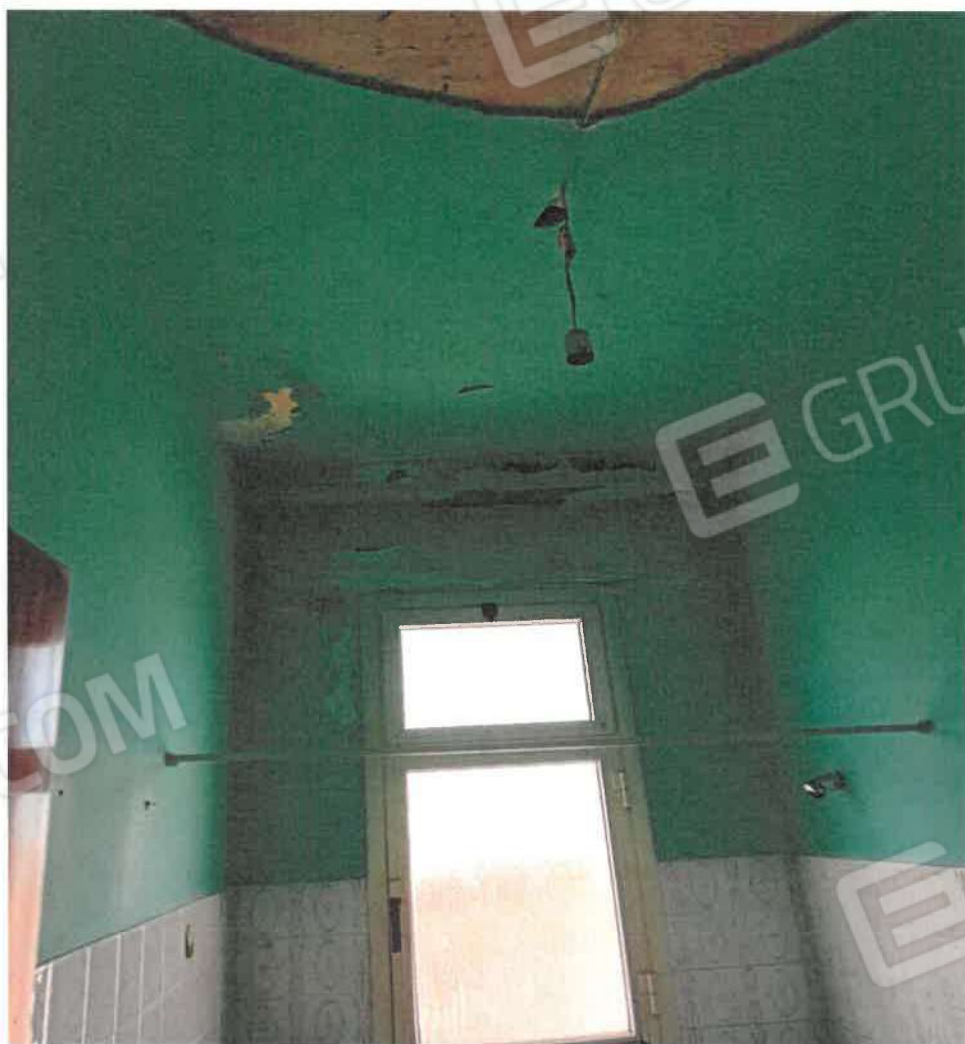
Foto n.ri 31-32 : soffitto locale bagno
