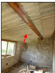
Foto n. 24 Interno Pollaio Evidenziata in rosso la copertura con pannelli in cemento-amianto
