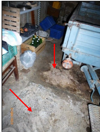
Foto 3 Particolare pavimentazione interna la freccia in basso indica zona con battuto cementizio, freccia in alto indica zona priva di pavimentazione
