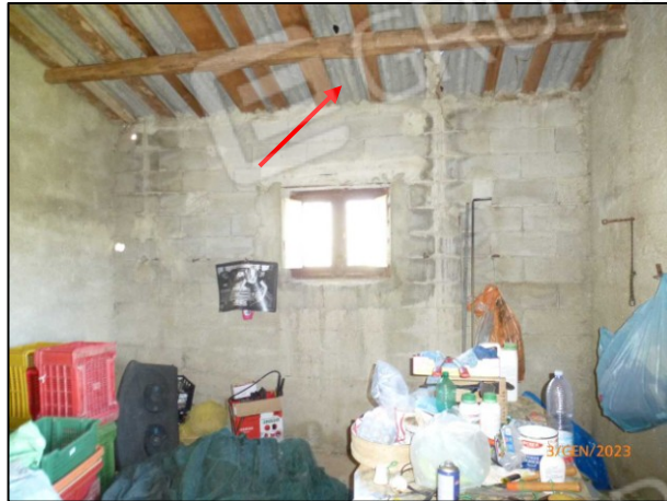
Foto 5 Altezza minima interna 3 m, evidenziata in rosso la copertura con pannelli in cemento-amianto
