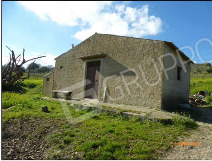
Foto 1 Prospetto ingresso Lati Est e Nord, immobile pignorato in Contrada Stato Comune di Roccapalumba, Fg. 9 p.lla 1662 sub 2. Abusivamente realizzato post anno 1967 e non sanabile
