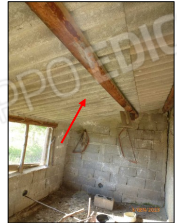
Foto 13 Interno Pollaio, evidenziata in rosso la copertura con pannelli in cemento-amianto
