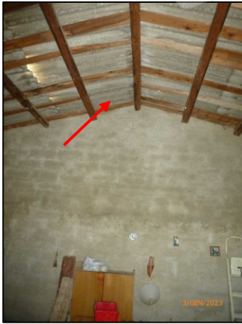
Foto 6 Altezza massima interna 3.90 m ° Evidenziata in rosso la copertura con pannelli in cemento-amianto
