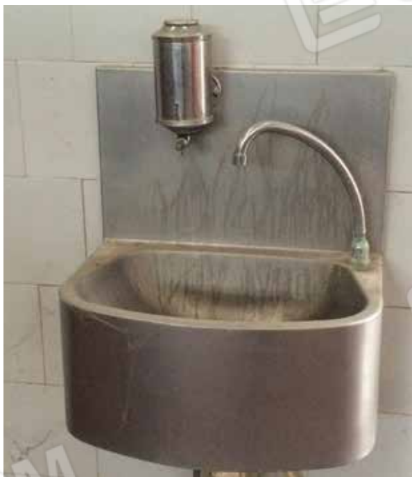
30. N. 2 lavandini in acciaio (Sala 1 - Edificio A).
