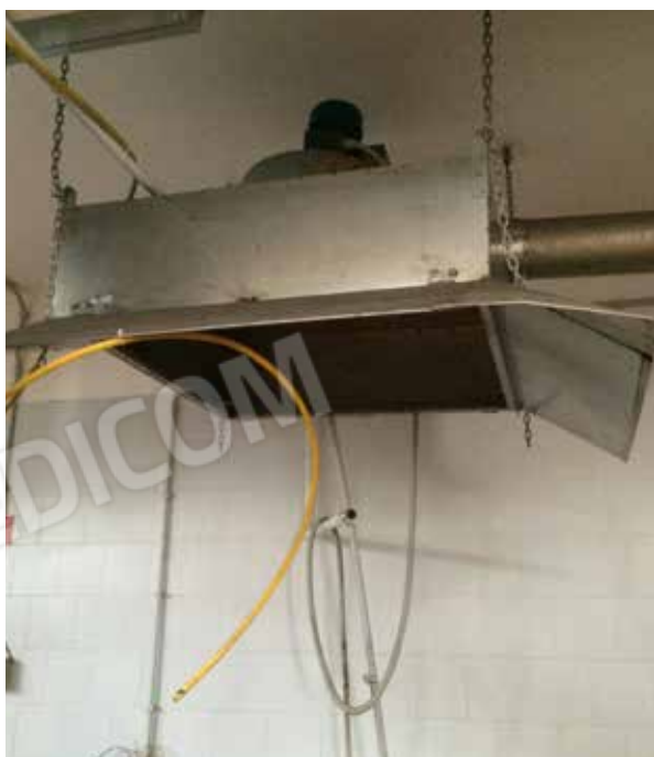
32. Cappa aspirante in acciaio (Sala 1 - Edificio A).
