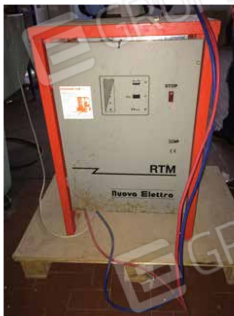
57. Alimentatore per sollevatore meccanico marca NUOVA ELETTRA 230/400 V 5,376 kW, n. matricola 21017254 mod. RTM (Zona confezionamento - Edificio A).
