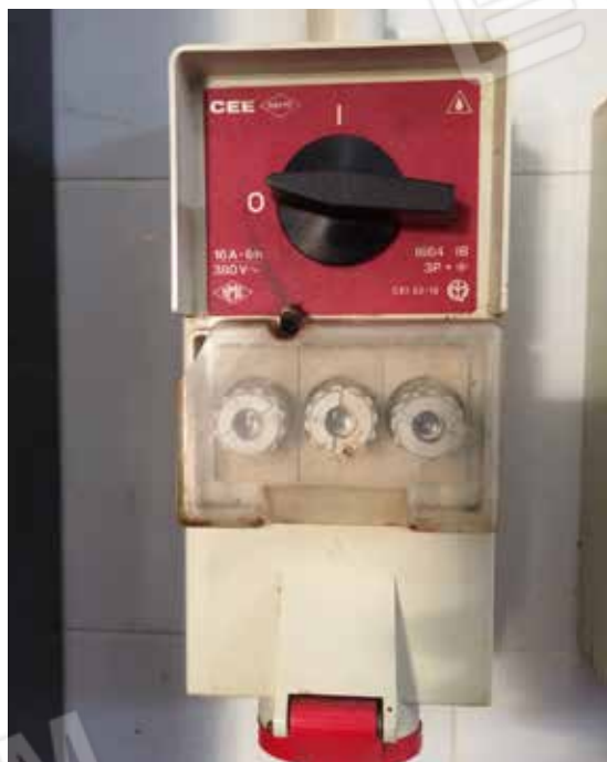
34 e 46. N. 5 interruttori - prese industriali da 380 V (Sala 1 - Edificio A).
