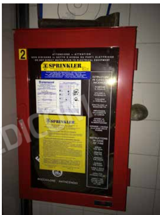
78. Manichetta idrante antincendio (Zona confezionamento - Edificio A).
