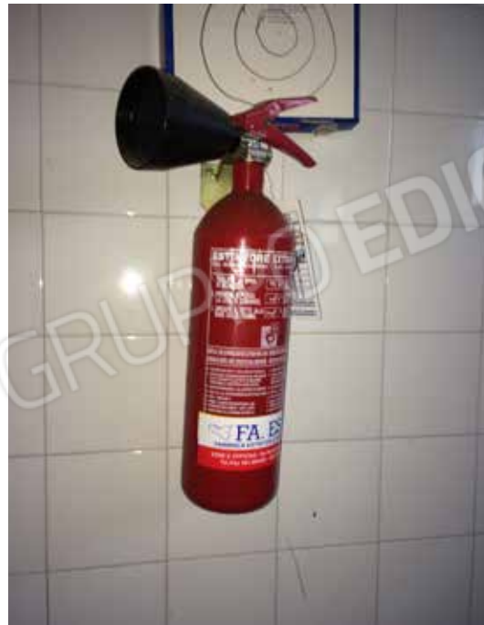
44. Estintore da 2 kg (Sala lavaggio - Edificio A).
