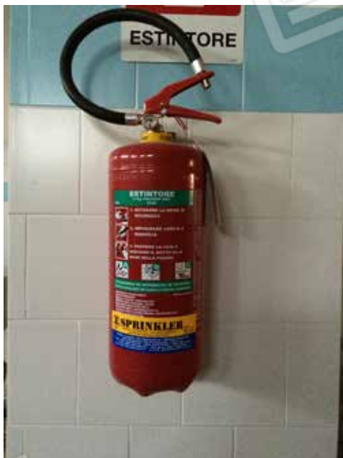
305. N. 7 estintori da 6 kg (Edificio B - Piano Terra retro)
