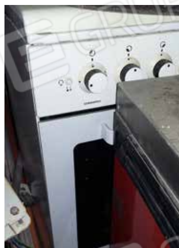
355. Cucina a quattro fuochi con forno (Edificio C)
