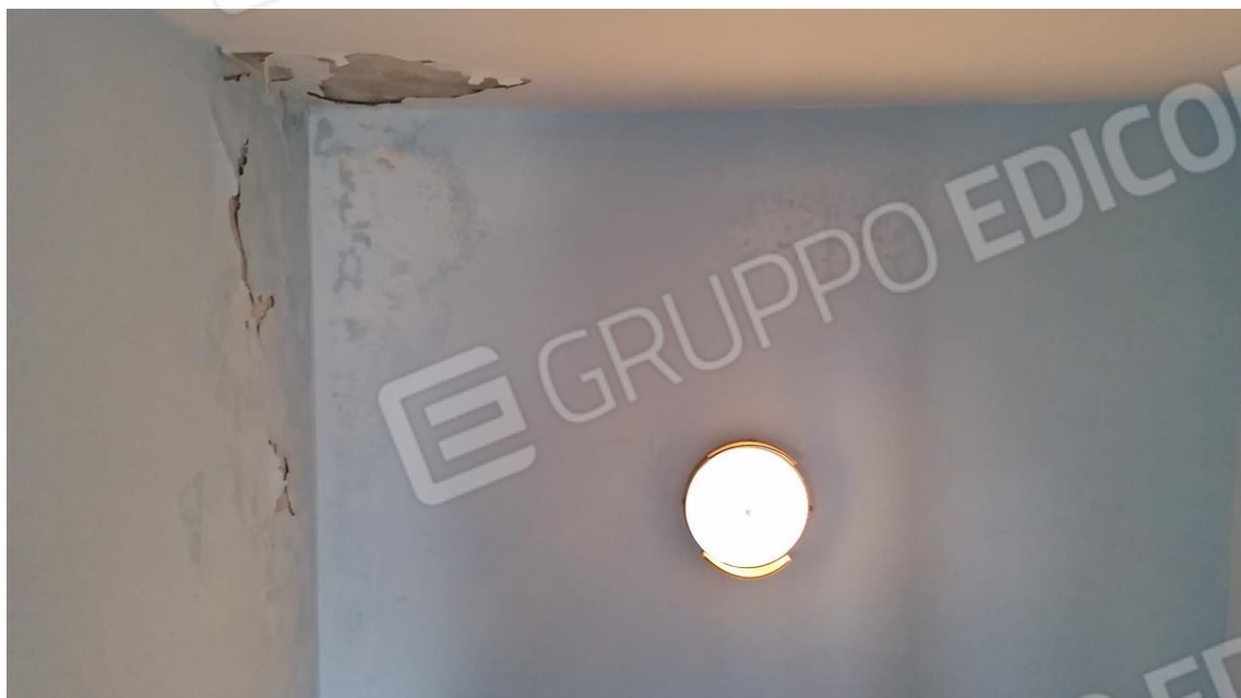
Figura 39: Particolare degli ammaloramenti presenti sull'intonaco delle pareti e dell'intradosso del solaio del vano scala
