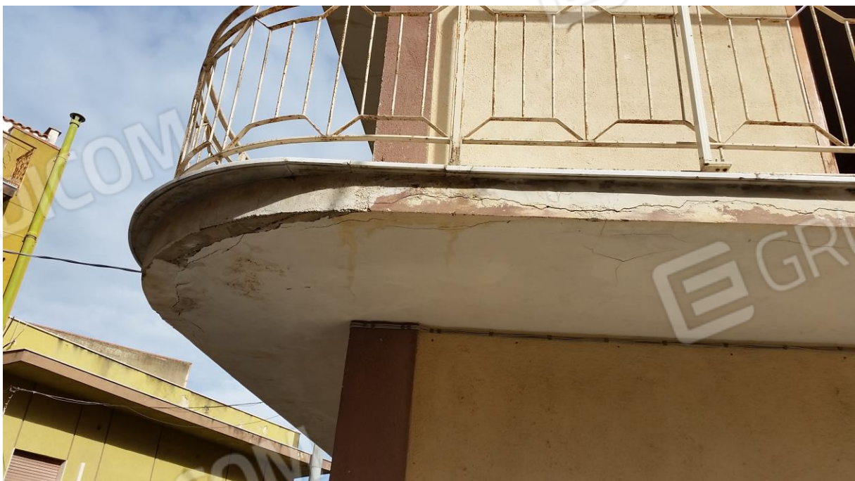
Figura 19: Particolare degli ammaloramenti presenti sull'intradosso del solaio del suddetto balcone
