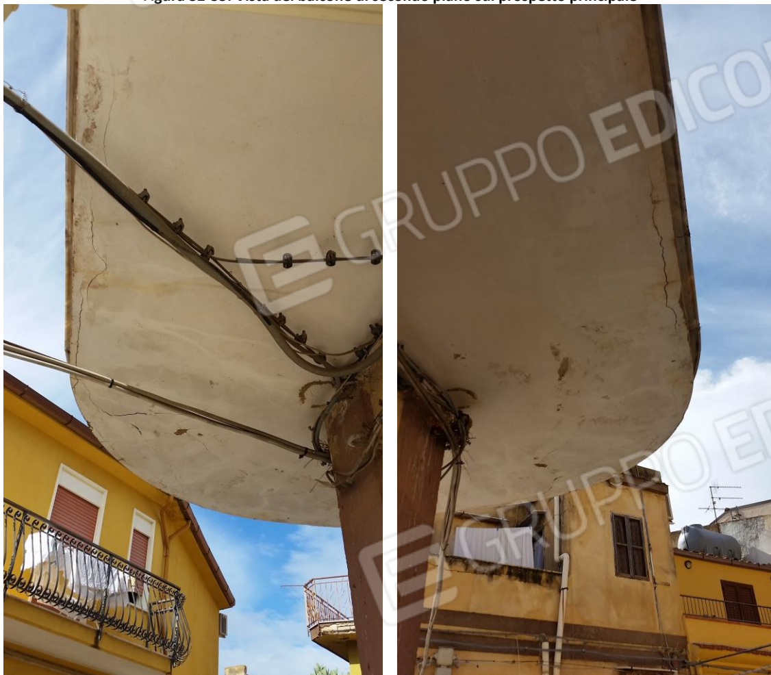
Figura 34-35: Particolari degli ammaloramenti presenti sull'intradosso del solaio del suddetto balcone
