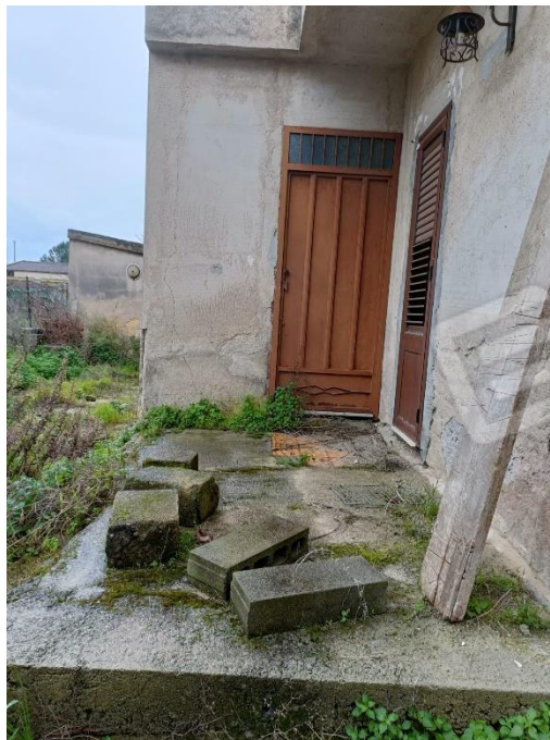
Foto 9. Porta di ingresso alla scala che conduce al piano primo e al lastrico solare
