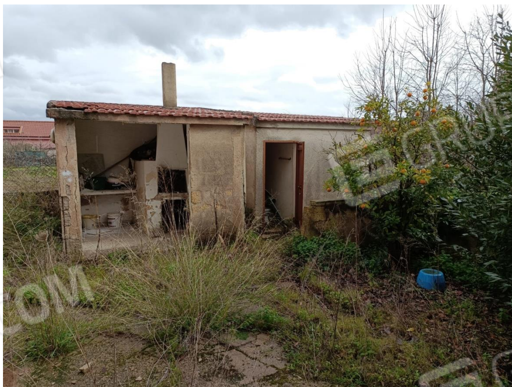
Foto 4. Corte esterna, piccolo manufatto in muratura abusivo e non sanabile, da demolire
