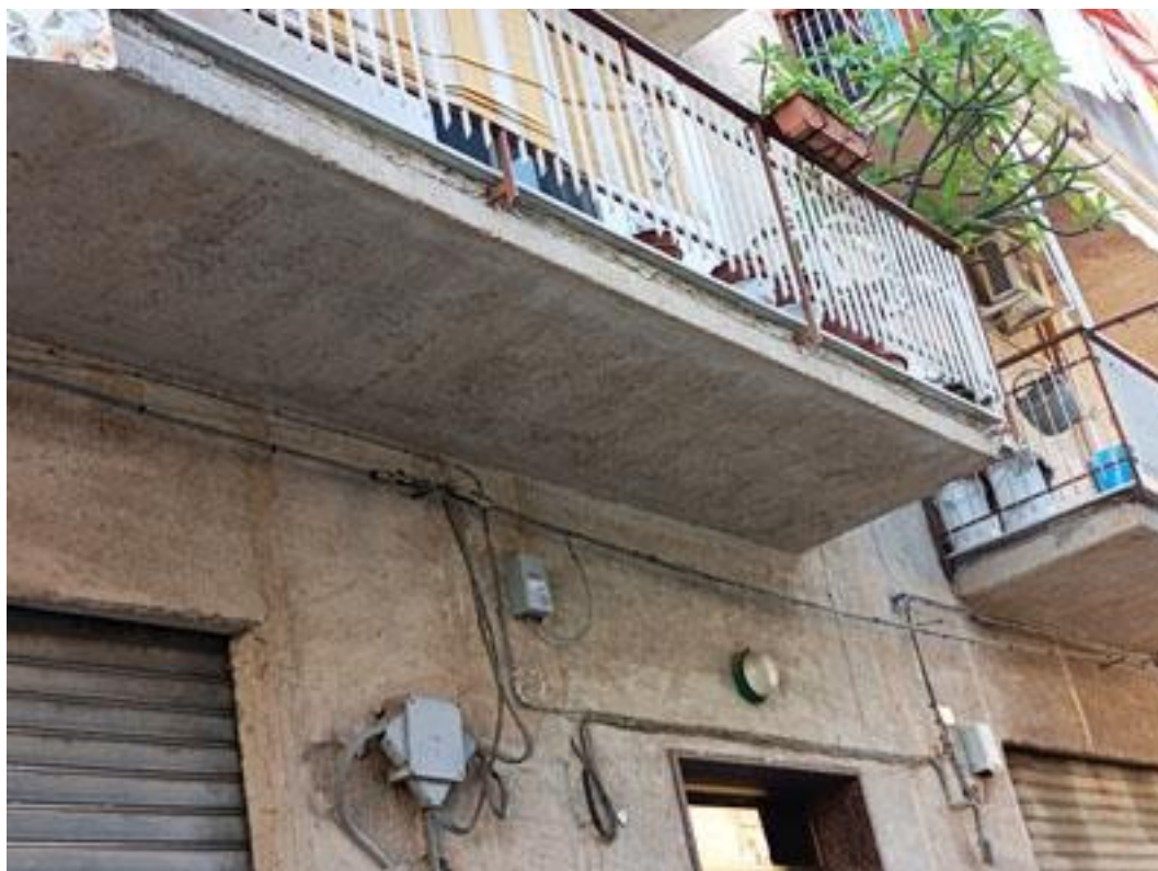
Balcone fronte principale – assenza di finitura dei paramenti murari
