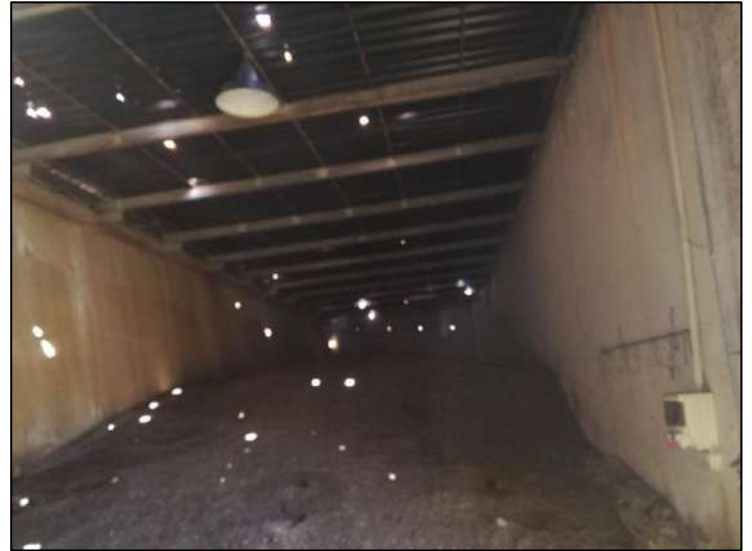
interno fabbricato abusivo
