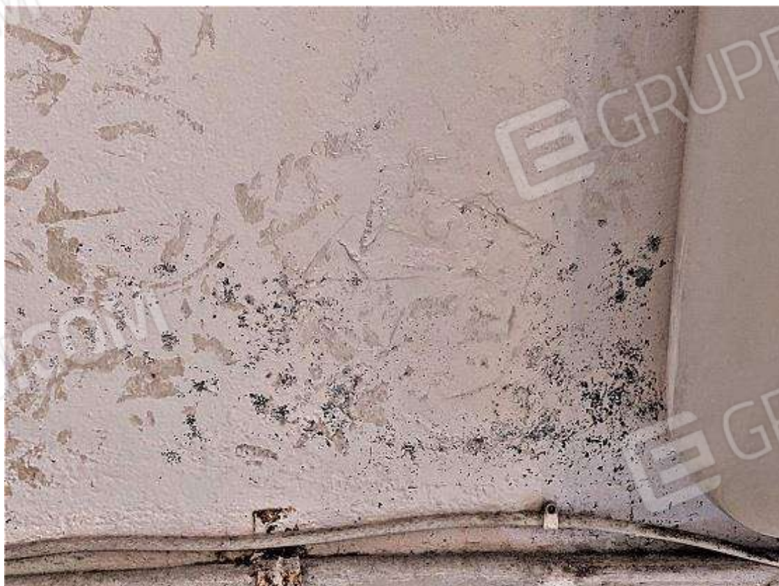
50 = Abitazione di 2°P – vano M (part. muffa)
