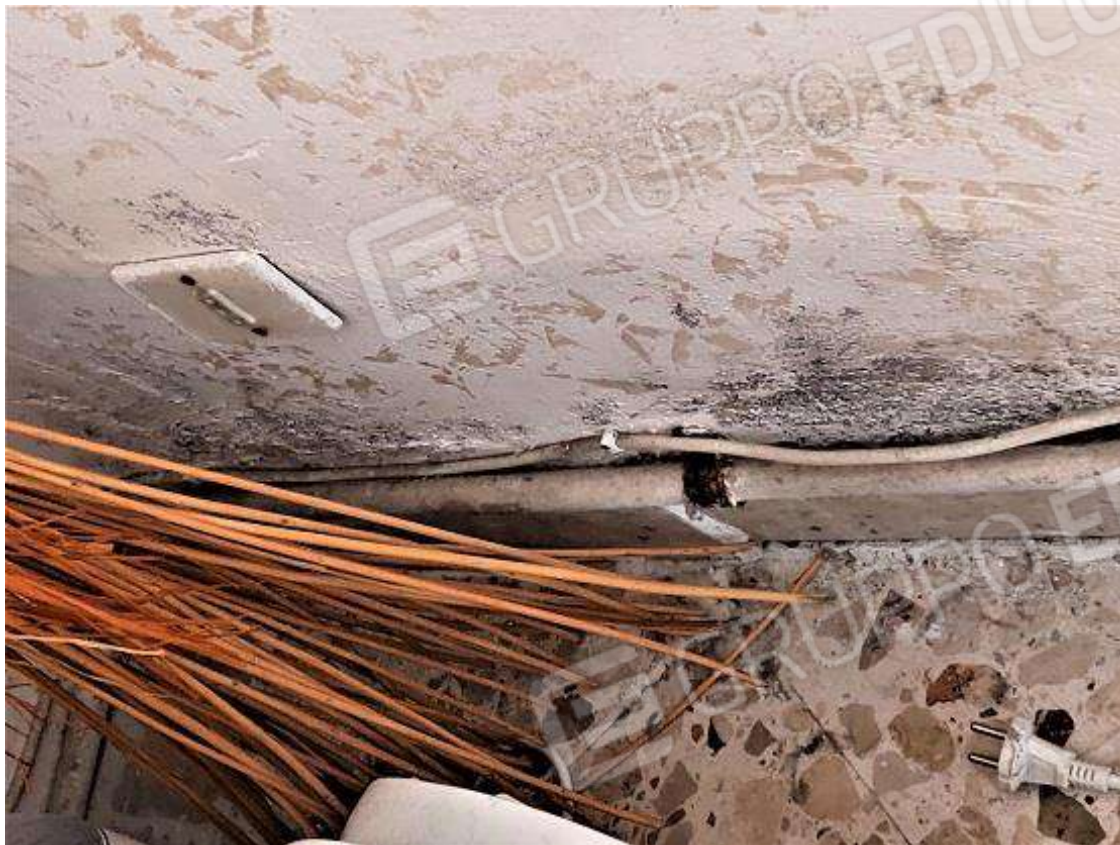
49 = Abitazione di 2°P – vano M (part. muffa)
