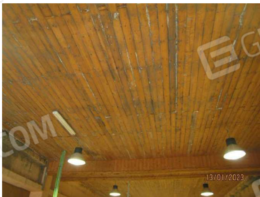
ammalorato a causa dell'umidità proveniente dalla copertura.
